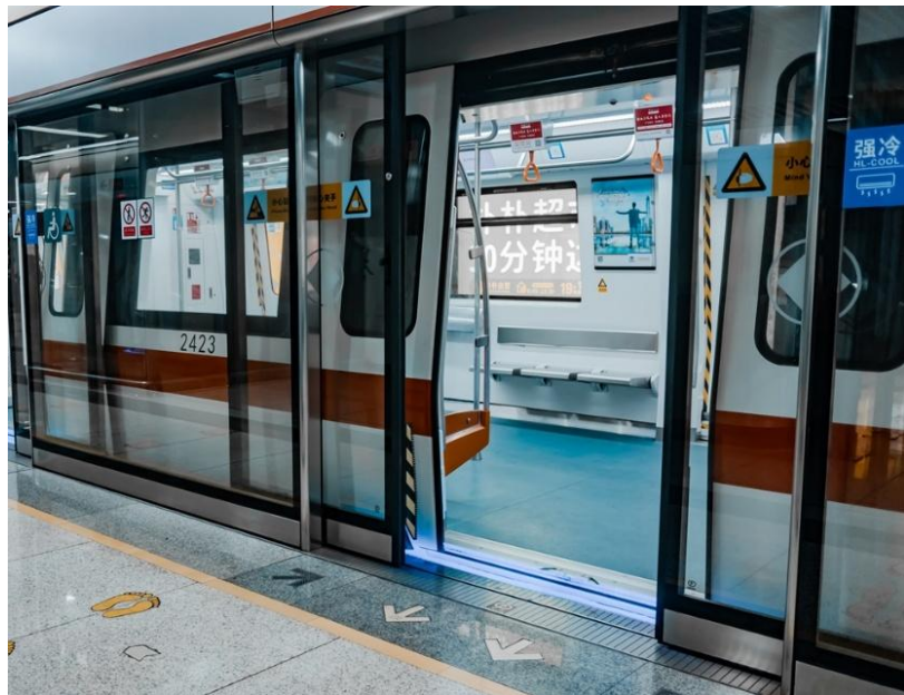
地铁安全门控制系统
